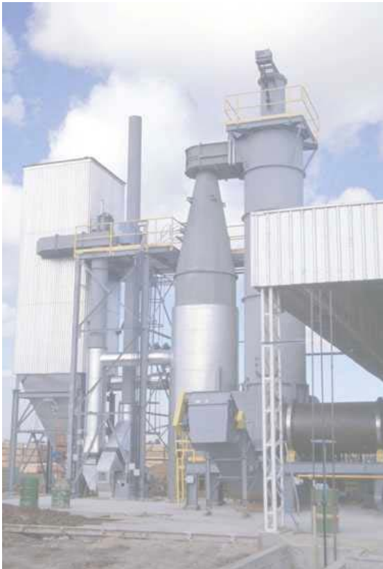
Ilustración 1: Incinerador de desechos peligrosos
